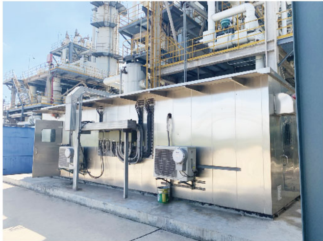
聚丙烯装置气体检测控制
