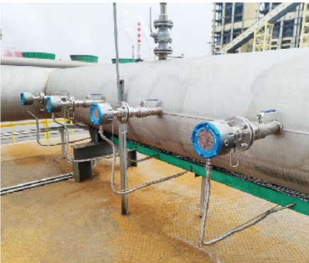
化产异味回收装置尾气治理 (氧气可燃气监测)
