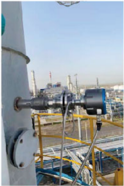
废气HCL (0-10ppm) 排放监测 (气液焚烧)
