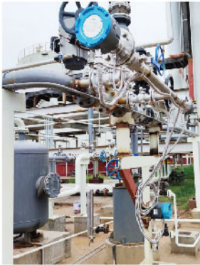
苯储存罐顶部尾气排放监测
