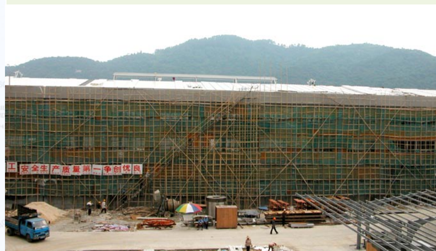
2005年6月，四期厂房建筑工地 June of 2005, construction sites of Phase IV workshop
